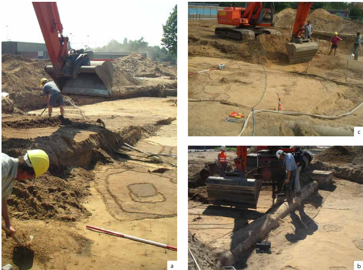
Figuur 5.3. Het aanleggen van het vlak werd plaatselijk bemoeilijkt door de vele kabels en leidingen die over het terrein liepen.
